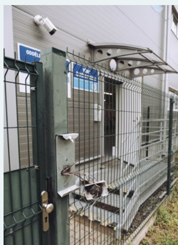
Zvonek, JIS a ovládání branky pro pěší do areálu "prádelna"; v pozadí u dveří další poškozená čtečka JIS
