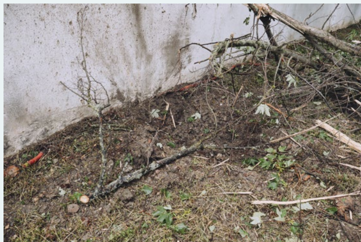
Detail místa vstupu bleskového proudu do kabelové sítě NCB – červená chránička podél stěny
