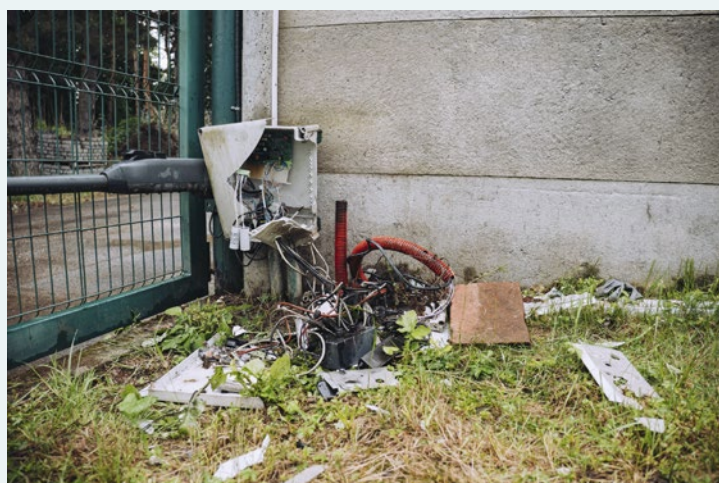
Skříň rozbočení komunikační sítě JIS (vpravo, zcela zničena) a ovládání brány „ČOV“ (vlevo její zbytky)
